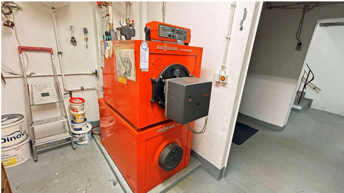
Öl-Zentralheizung, Baujahr 1988 mit Warmwasser
