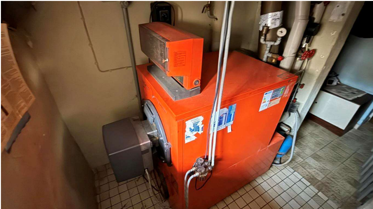
Öl-Zentralheizung, "Viessmann", Baujahr 1981
